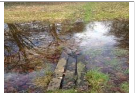
Bij de aanleg moerasbrug niet op zoveel hemelwater gerekend.
